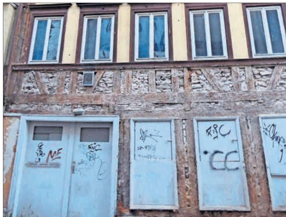
In diesem Haus bedienten Frauen Freier. Laut SWSG ist sein Zustand katastrophal. Foto: red
